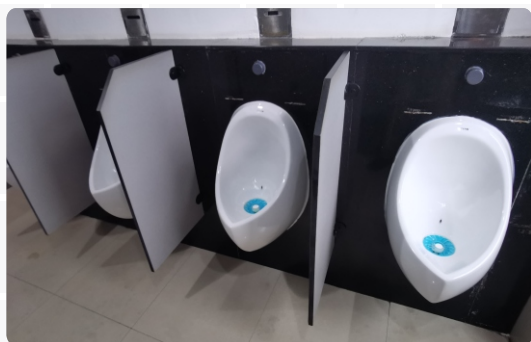
河南信阳市政府大楼节水改造
